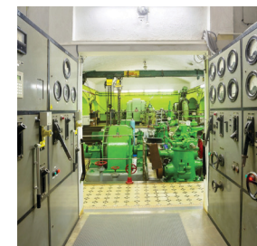
▲ VN rozvodňa ovládania generátorov
