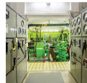
▲ VN rozvodňa ovládania generátorov
